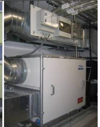
6. Lüftung im KG
